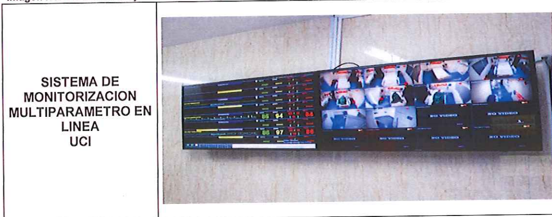
Imagen No. 16. Suministro y Dotación de Equipos
